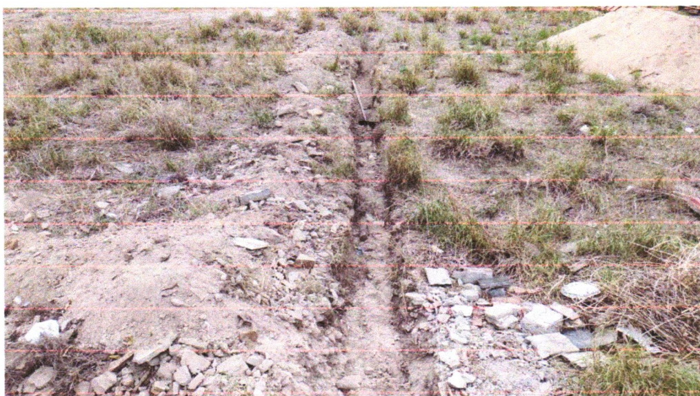
FOTO 02 – ESCAVAÇÃO MANUAL DE VALA PARA VIGA BALDRAME (INCLUINDO ESCAVAÇÃO PARA COLOCAÇÃO DE FÔRMAS), AF_06/2017
